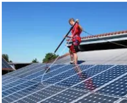
Cellules photovoltaïques et son « kit » de lavage
